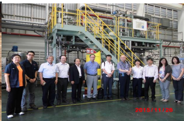
タイ: 科学技術研究院のBDF製造パイロットプラント
