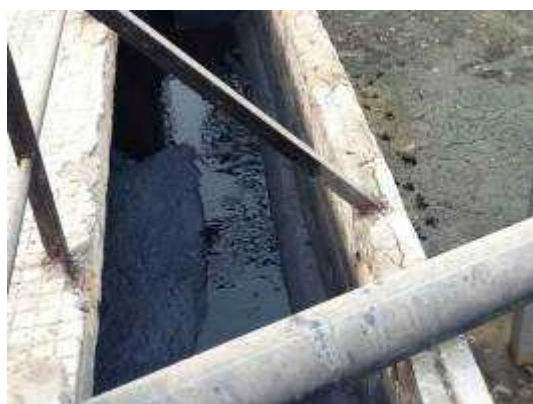
写真 6 UASB 上部まで汚泥が堆積した様子
