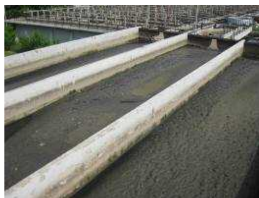
写真 7 グリットチャンバー（沈砂池）に砂が堆積した様子
