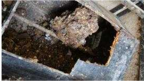
図-4. 2. 5 反応槽の破損状況
