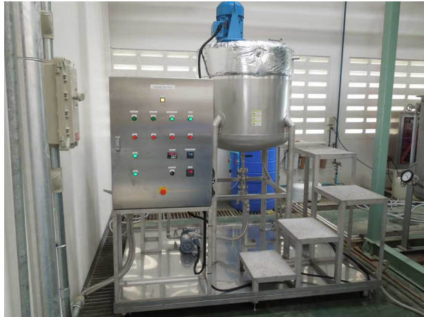
図7 タイ科学技術研究院内に設置された脱ガム試験装置
