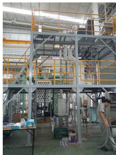
図 10 タイ科学技術研究院内に設置されたバイオオイル製造用流動層型熱分解炉パイロットプラント（約 20kg/h 規模）
