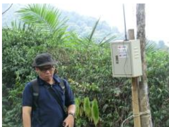
写真8 無線システム。
