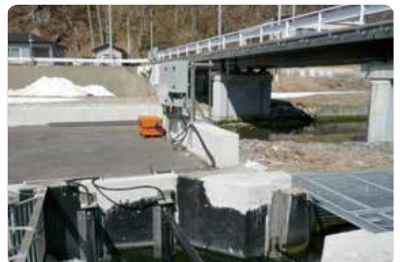
岩手県下安家ふ化場に設置されたPitタグ受信システム
