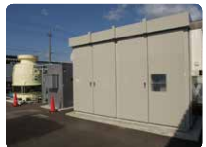
② パッケージボイラーの外観
