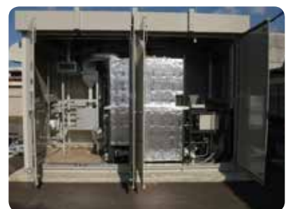
③ ボイラーシステムのパッケージ内部
