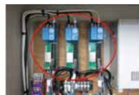
(a) 屋外集約箱への設置状況(赤丸内)
