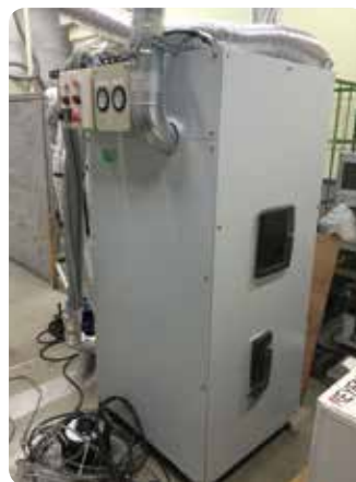
排ガス処理装置
