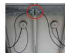
(a) パネル裏への設置状況(赤丸内)
