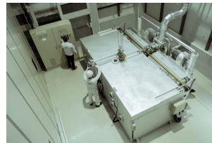
導入した大型高温構造試験装置
