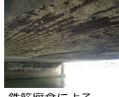
鉄筋腐食によるコンクリート劣化
