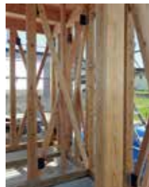
DIT制振筋かい金物の設置状況
