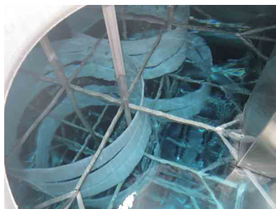
図5 受水槽内に設置された制振装置
