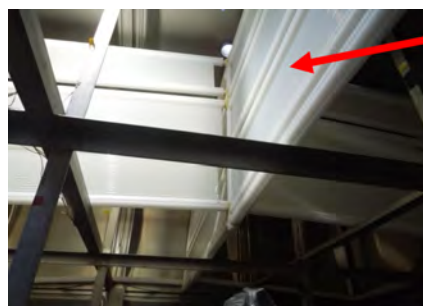
貯水槽内に設置された制振装置
