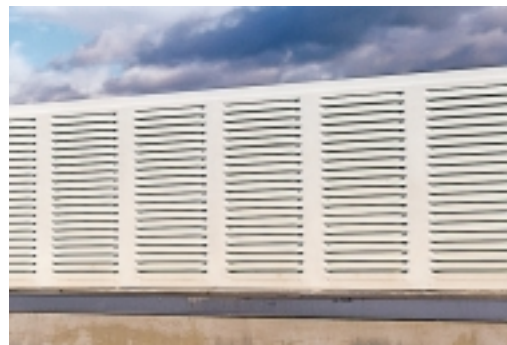
常温乾燥型大気浄化塗料を塗布した遮音壁
