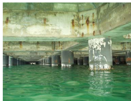
・栈橋部分の劣化・損傷
