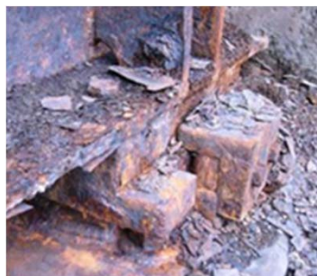
・鋼橋の桁端部の腐食
