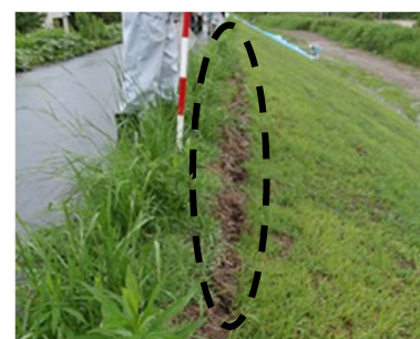
・河川堤防の亀裂
