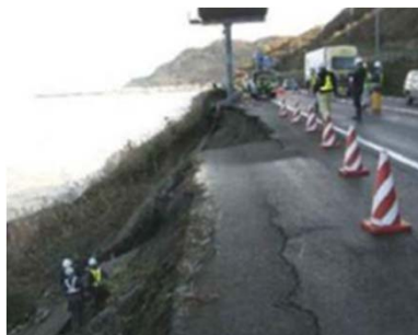
・盛土のり面の崩壊
