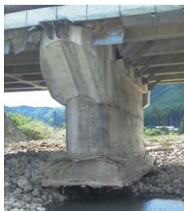
・橋脚の洗掘
