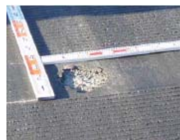
・アスファルト舗装の表層剥離
