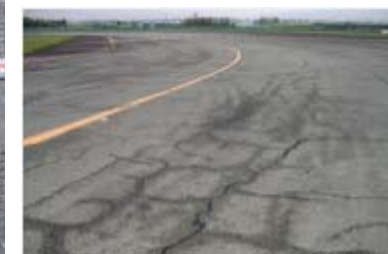
・アスファルト舗装のひび割れ
