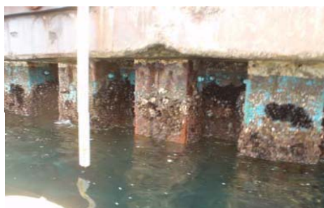
・岸壁部分の被覆防食の劣化・損傷
