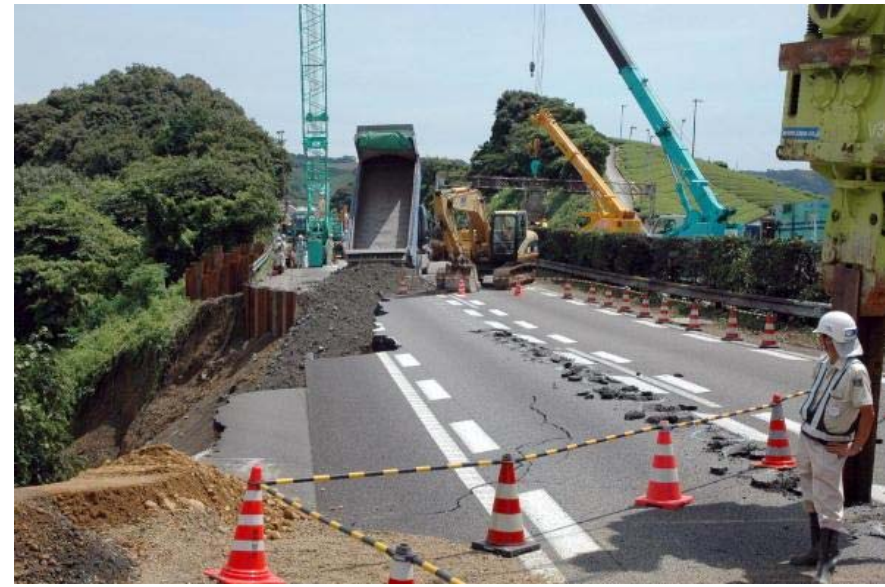
平成21年8月11日駿河湾の 地震 による盛土崩壊 (東名高速道路)
