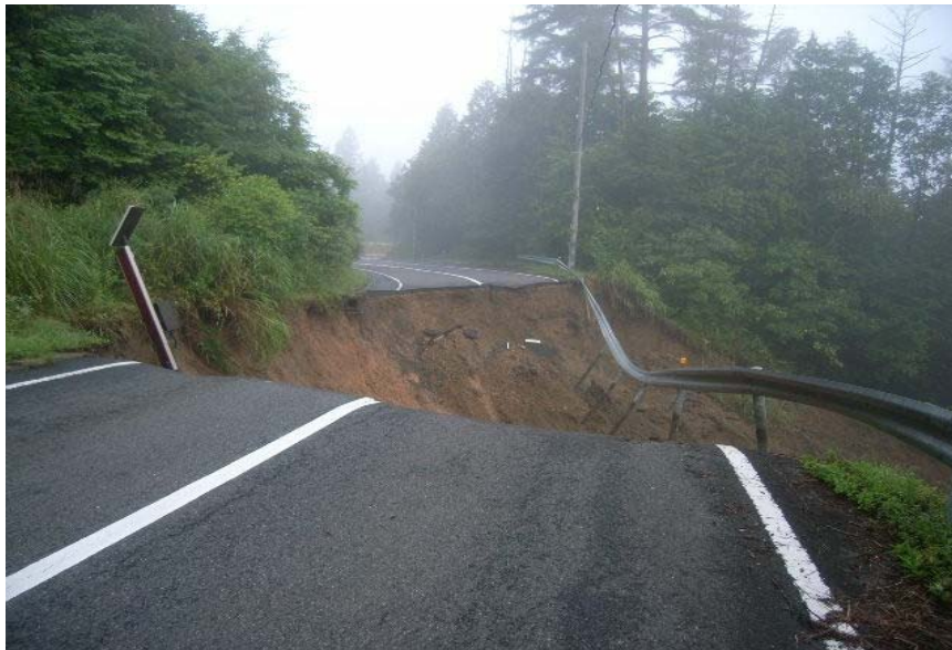
平成21年7月31日～8月3日 豪雨 により発生した (一)飛騨木曾川公園線(御嵩町)の盛土崩壊
