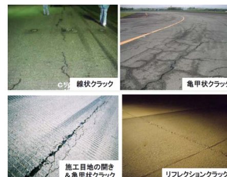
国土省航空局「アスファルト歩道の変状と空港舗装点検技術の現状」より
