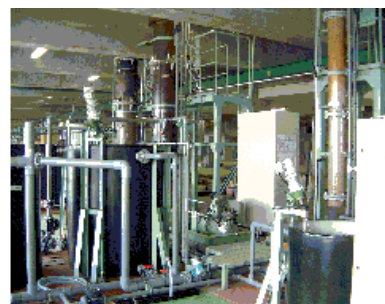
写真1 水資源回収技術の実験装置
