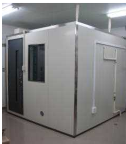
写真（ヤマハの防音室を改造した計算機サーバ室。 貧乏時代の工夫の証。）
