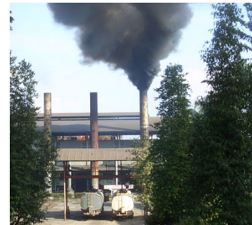
老朽化したEFBボイラ
