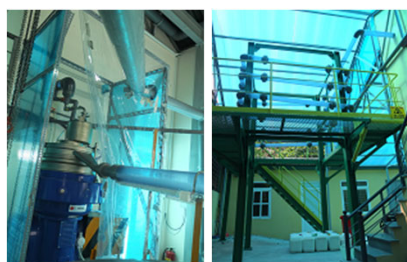
ハノイ工科大に設置した天然ゴム生成テストプラント
