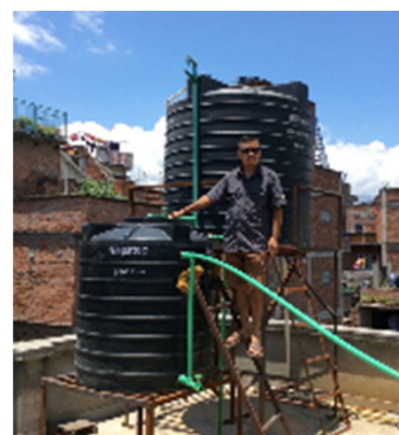
現地砂ろ過装置
