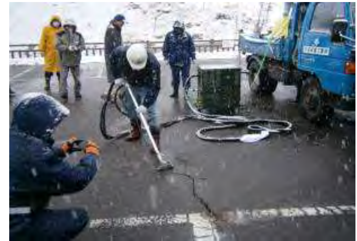
循環回収型除染機(初号試作機)による伊達市内クラック部の除染実験
