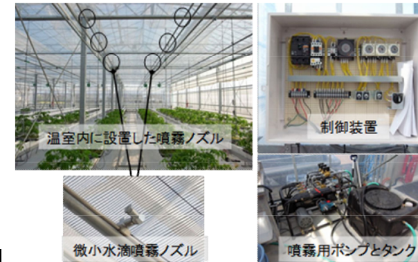
図1 植物工場内に設置した微小水滴付着式生長点冷却システム
